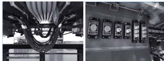
合肥地铁3号线中高压跨接线束应用
