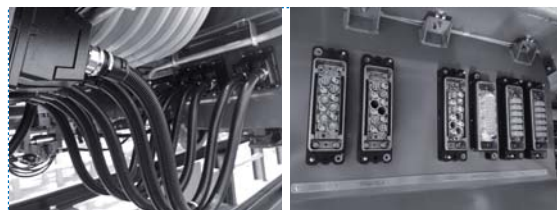
合肥地铁3号线数据低压跨接线束应用
